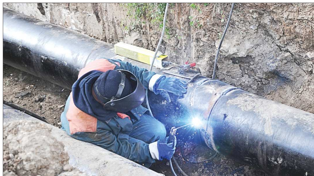
Нижнесалдинские коммунальщики пытались устранить порыв, но вскоре поняли, что это бесплозно – требуется замена большого участка трубы. Пока этого не произойдёт, тепло в центральной части города не появится. Сейчас в Нижней Салде объявлен режим ЧС
