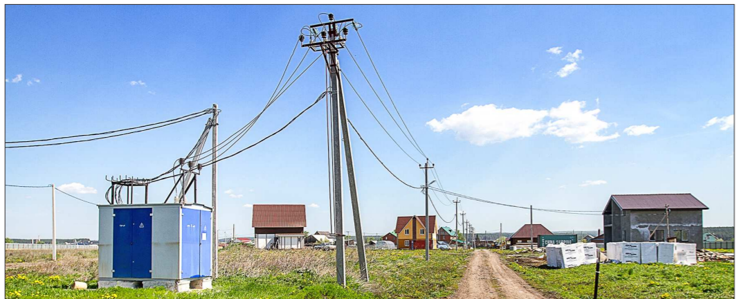
Преобразование Бобровского в «мини-мегаполис» надо начинать с подстанции
