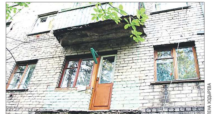
Этот балкон обвалился три года назад, потому что арматурная сетка, которая должна была его держать, полностью проржавела
