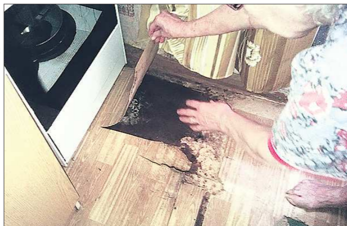
На кухне у Елизаветы и Павла Котовых содержимое канализационных труб заполнило подполье и поднялось под самым линолеумом. То, что это не повторится после ремонта, хозяева не уверены
