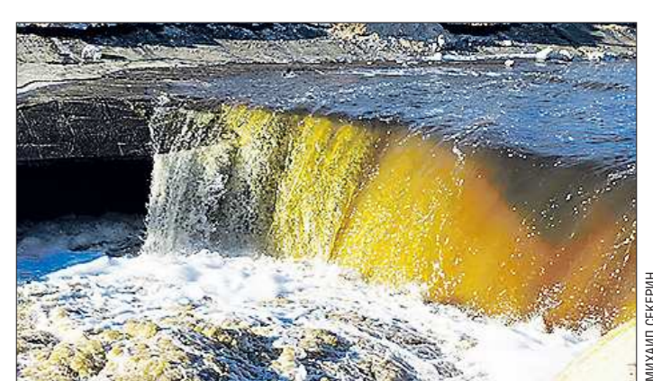
Провал в русле Ваграна образовался в минувшие выходные. На территории Североуральского городского округа около 73 км рек и ручьёв забраны в бетонные берега. Это сделано для того, чтобы предотвратить попадание воды в подземные выработки шахт
