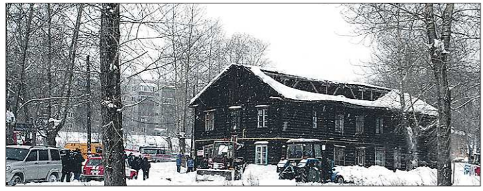
Кровля не выдержала веса снега и порыва трубы отопления на чердаке. Барак 1935 года постройки наконец-то решено снести
