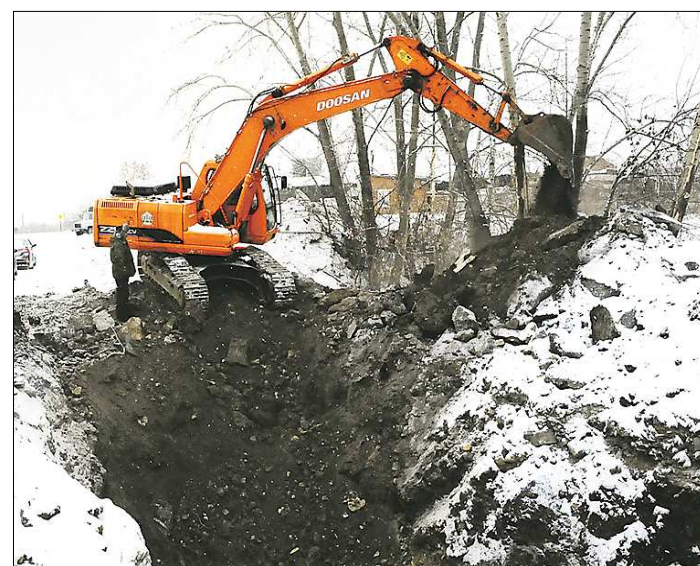
Вчера началось восстановление ветки самого старого водовода в городской черте. Это позволит обеспечить дополнительное водоснабжение Сухого Лога
