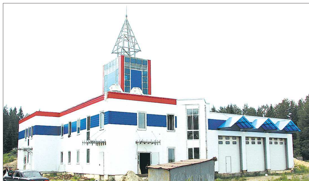
Не «ожарка», а настоящий дворец для огнеборцев возводится в деревне Починок. Увы, пока стройка заморожена, а сельчанам остаётся только надеяться на дождливое лето
