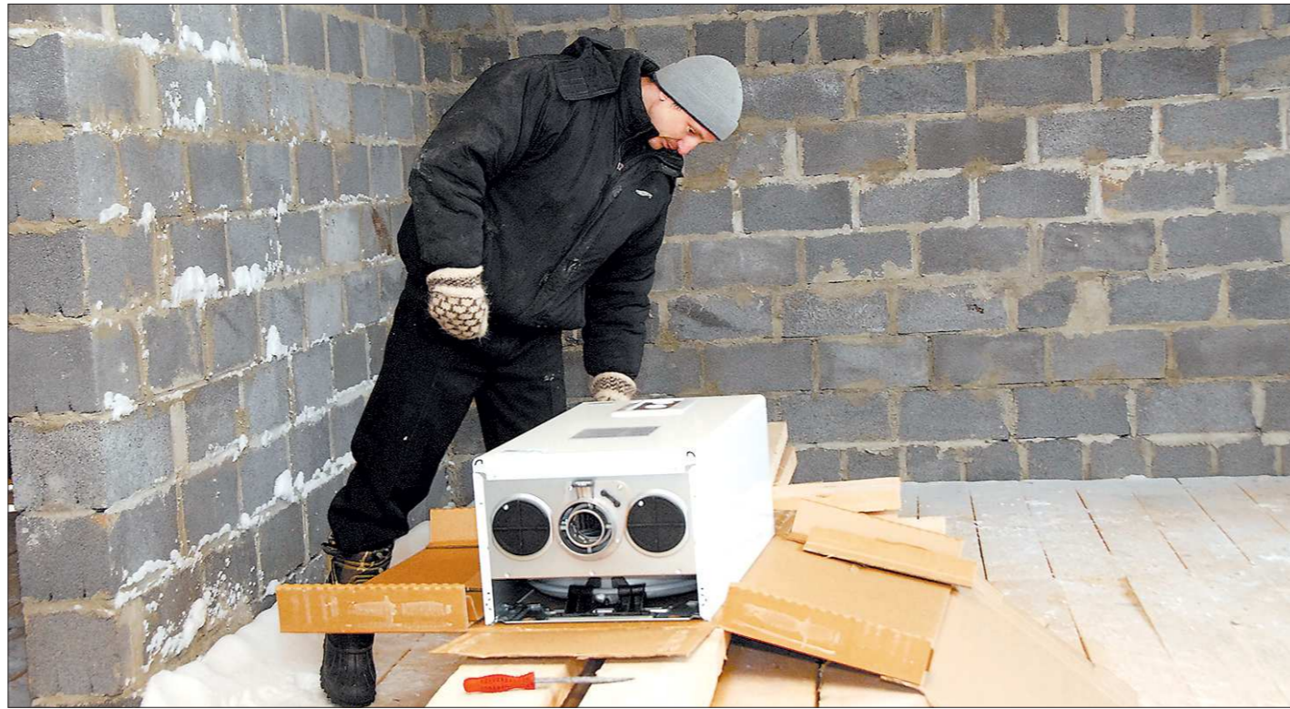
Житель Невьянска Илья Шушаков придирчиво осматривает газовый котёл, который скоро установят в его новом доме
