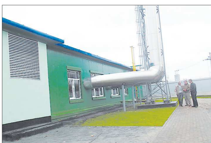
В Верхнем Дуброво пять работающих на газе муниципальных котельных. Эта — самая современная
