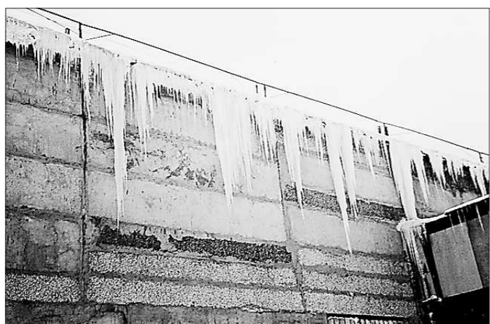
Мягкая кровля до ремонта
