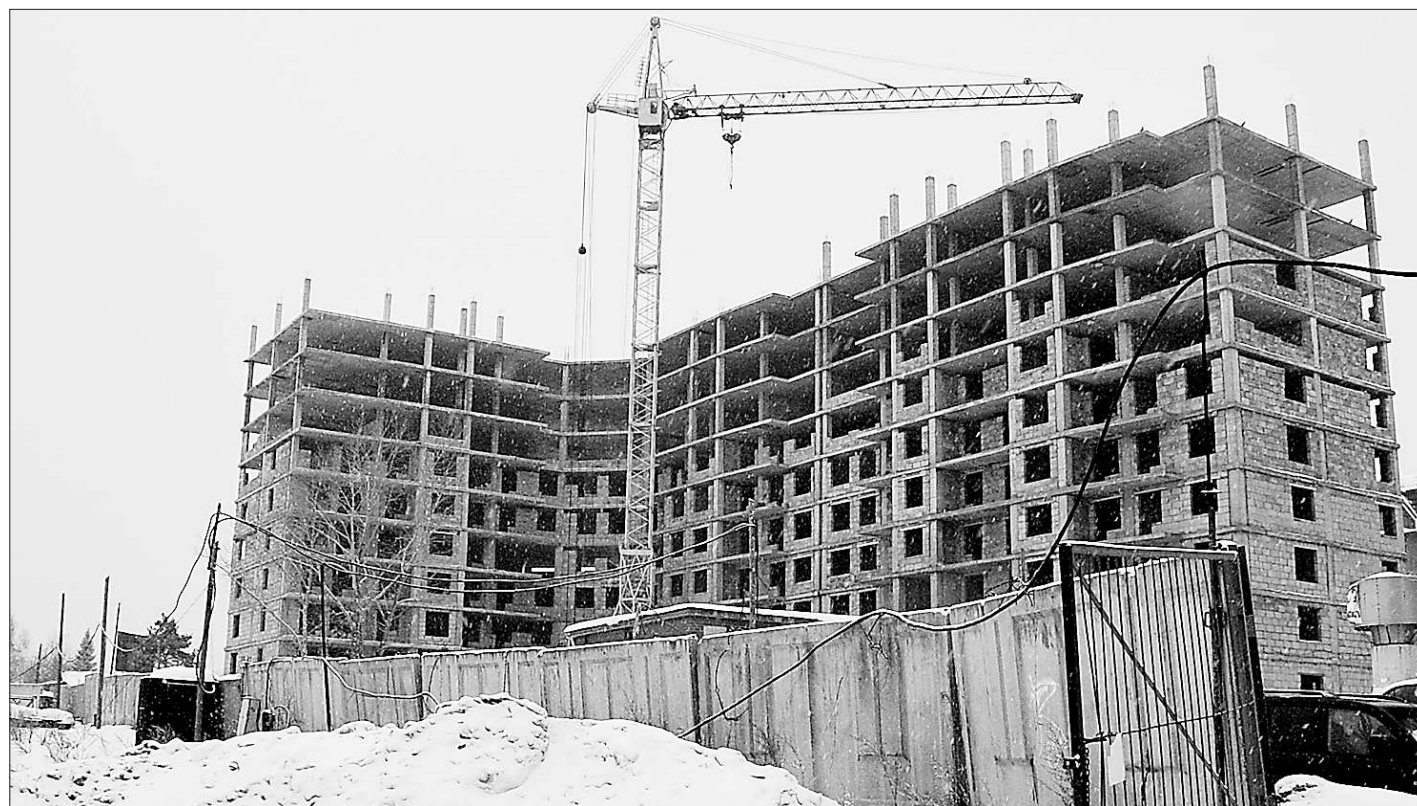
Дом на Рошинской — застройщик разорился, ситуацию «разруливает» конкурсный управляющий. Фото Алексея КУНИЛОВА
