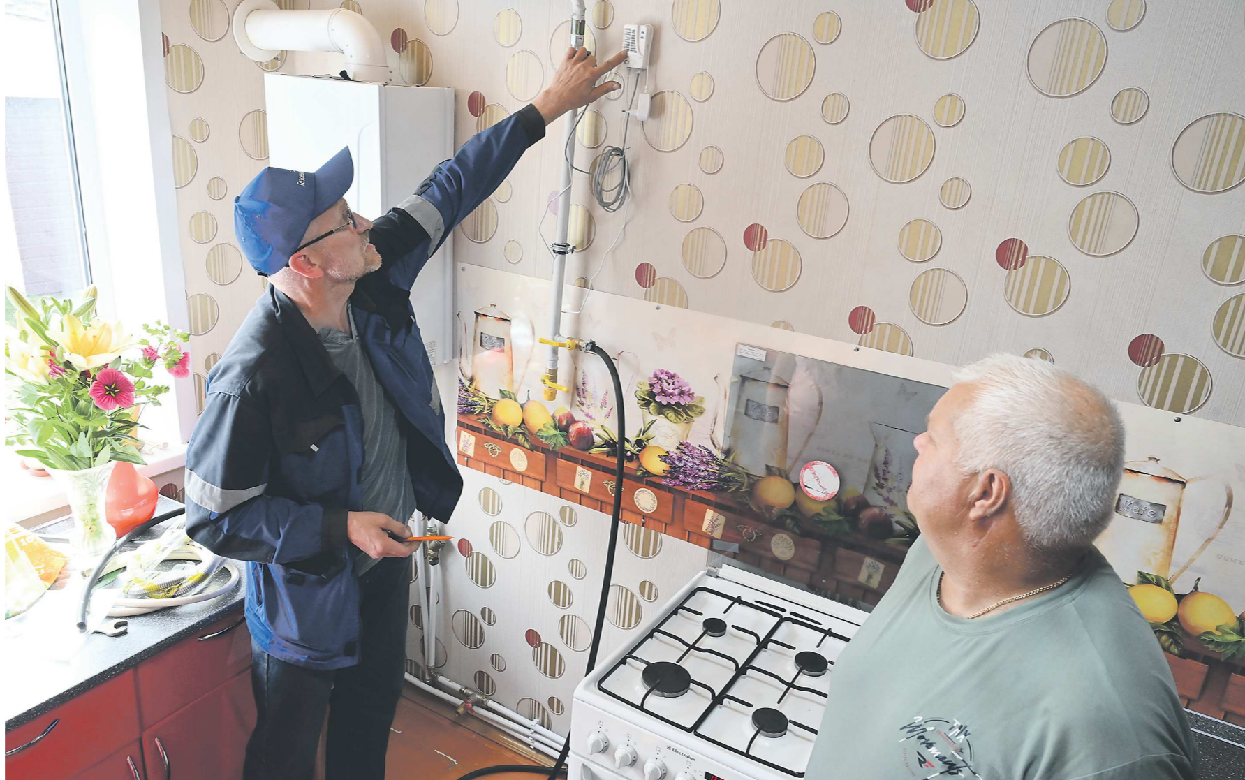
Всего на территории Свердловской области работают шесть газоснабжающих организаций, им и доверяют обслуживание и ремонт оборудования в жилых домах
