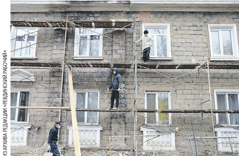
В перечень ремонтных работ входит восстановление фасада дома, замена кровли, внутренних коммуникаций, лифтов
