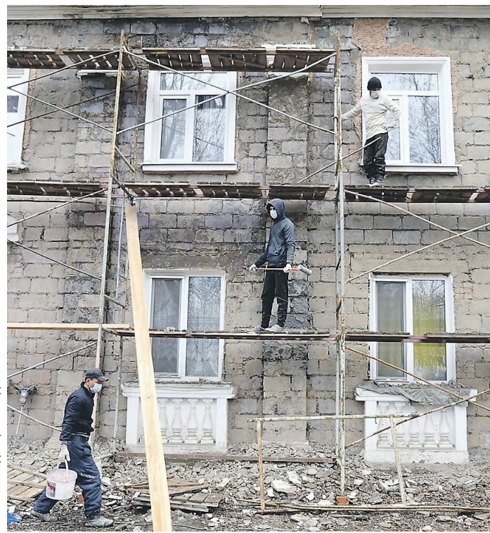
В перечень ремонтных работ входит восстановление фасада дома, замена кровли, внутренних коммуникаций, лифтов
