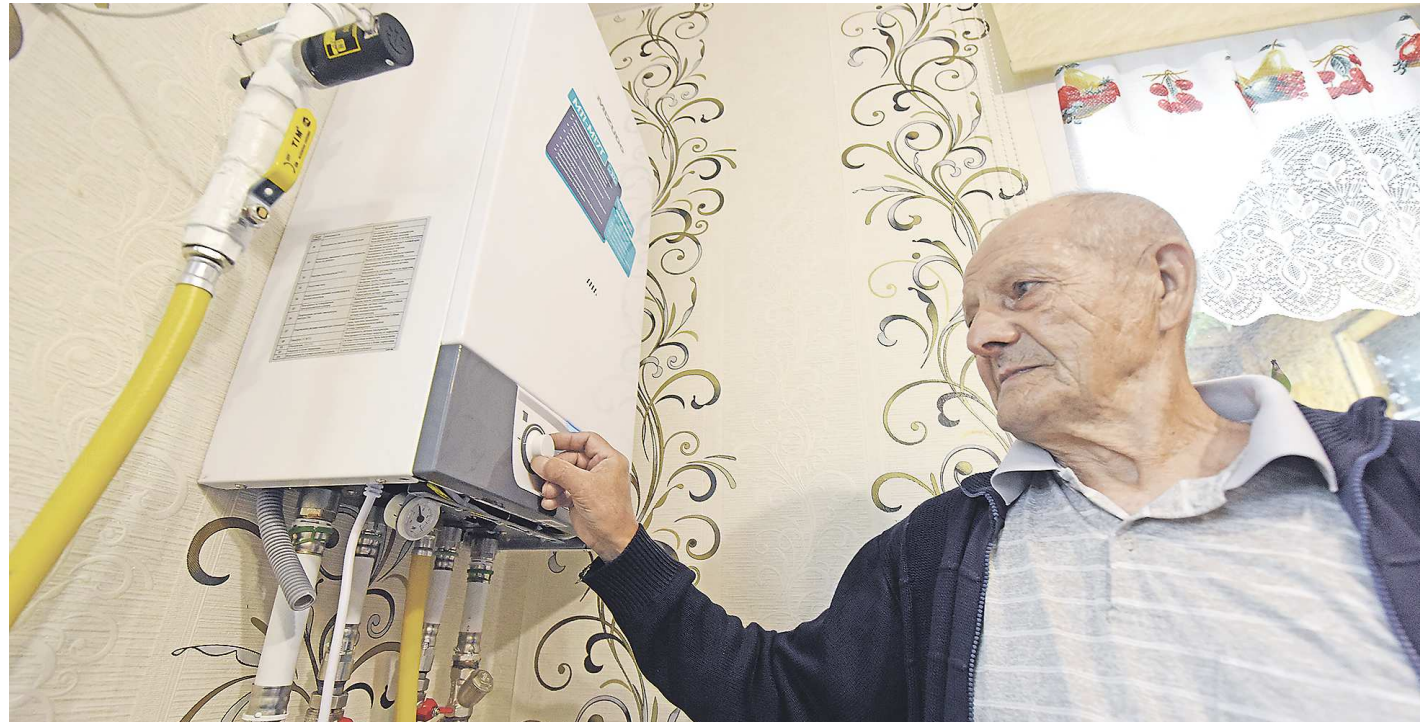
Покупку и установку внутридомового газового оборудования по закону должен оплачивать собственник жилья
