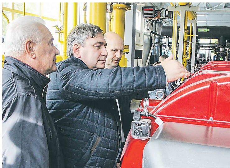
Николай Смирнов осматривает оборудование новой котельной в поселке Ленинском Каменска-Уральского, запущенной в сентябре этого года
