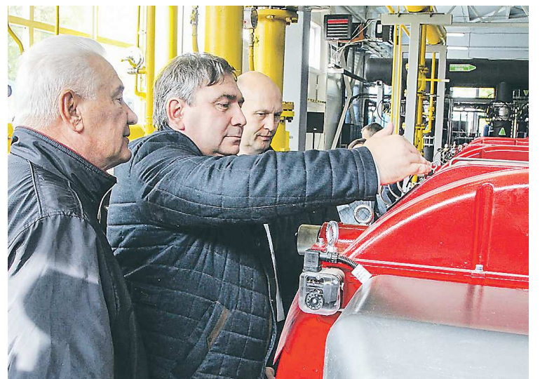
Николай Смирнов осматривает оборудование новой котельной в поселке Ленинском Каменска-Уральского, запущенной в сентябре этого года
