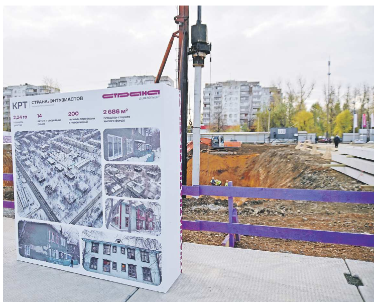
В Орджоникидзевском районе Ирек Файзуллин и Евгений Куйвашев дали старт строительству жилого комплекса по программе комплексного развития территорий
