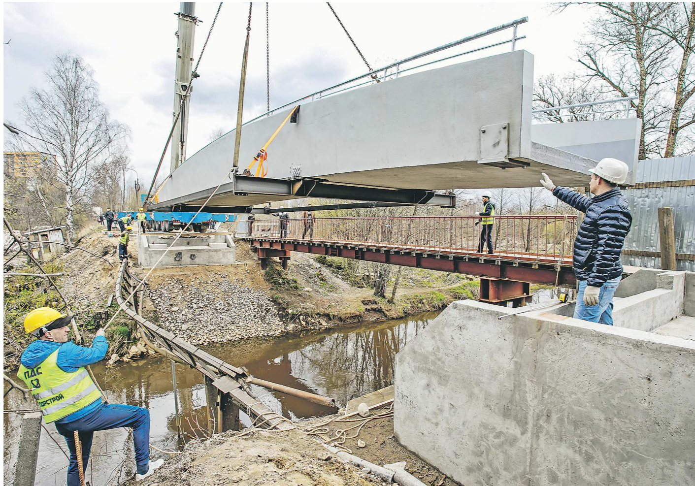
Мост из композитных материалов, впервые построенный в Санкт-Петербурге в 2020 году. Скоро такие появятся и в Свердловской области
