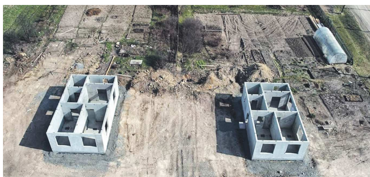
Дома возводят из готовых железобетонных конструкций, что позволяет строить коробки за считанные дни
