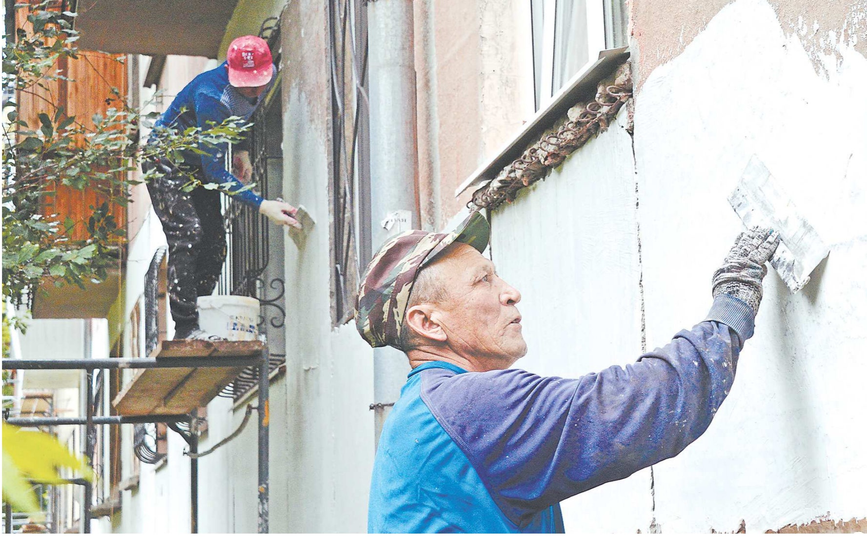
В перечень работ по капремонту входит: обновление фасада и кровли дома, укрепление фундамента, замена внутренних коммуникаций (тепло-, водо-, электроснабжение), лифтов и ремонт подвальных помещений
