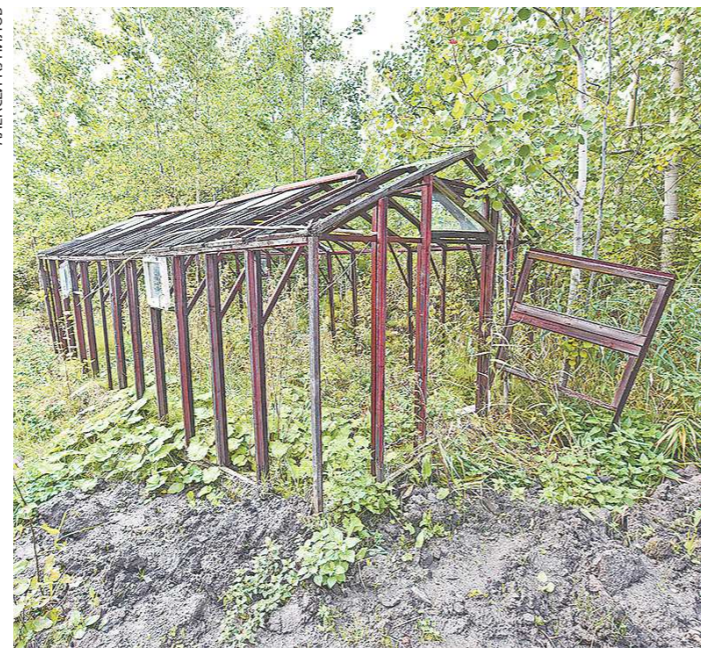
Такие участки создают угрозу пожаров
