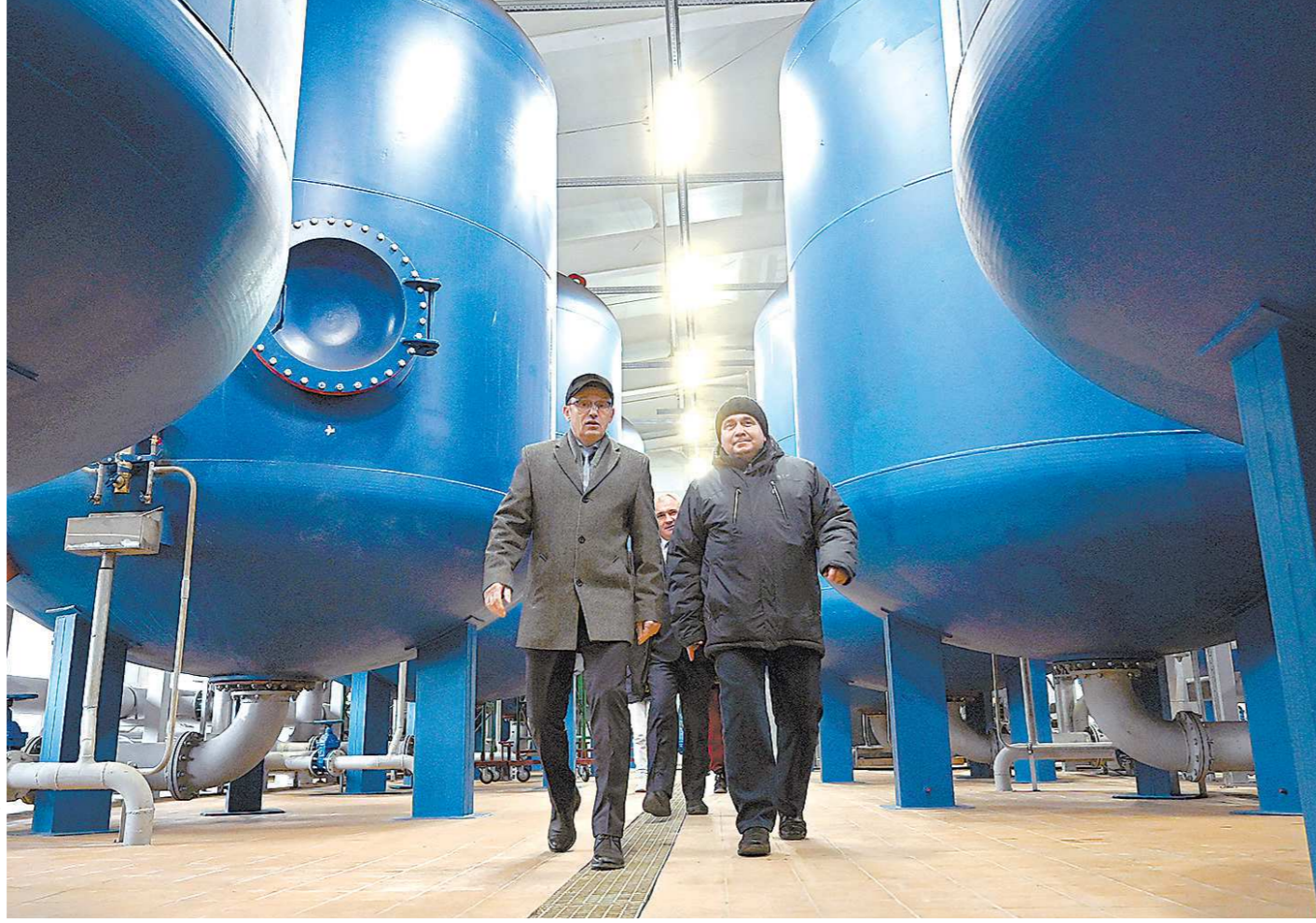
Глава Кушвы Михаил Слепухин (слева) и министр энергетики и ЖКХ Свердловской области Николай Смирнов на обходе водоочистных фильтров новой системы водоснабжения Кушвы - всего их 12
