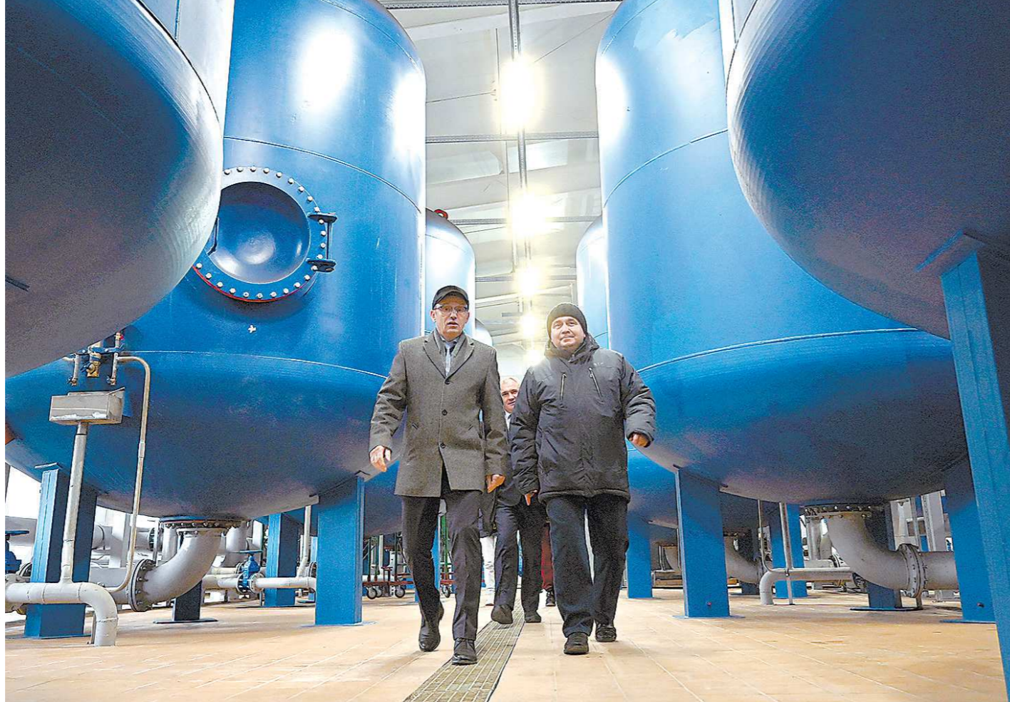
Глава Кушвы Михаил Слепухин (слева) и министр энергетики и ЖКХ Свердловской области Николай Смирнов на обходе водоочистных фильтров новой системы водоснабжения Кушвы – всего их 12
