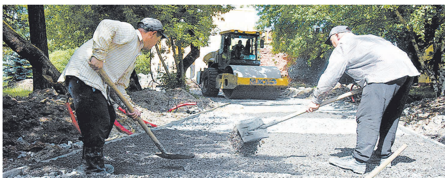
Парк культуры и отдыха металлургов: строители делают основание под плитку на пешеходных дорожках
