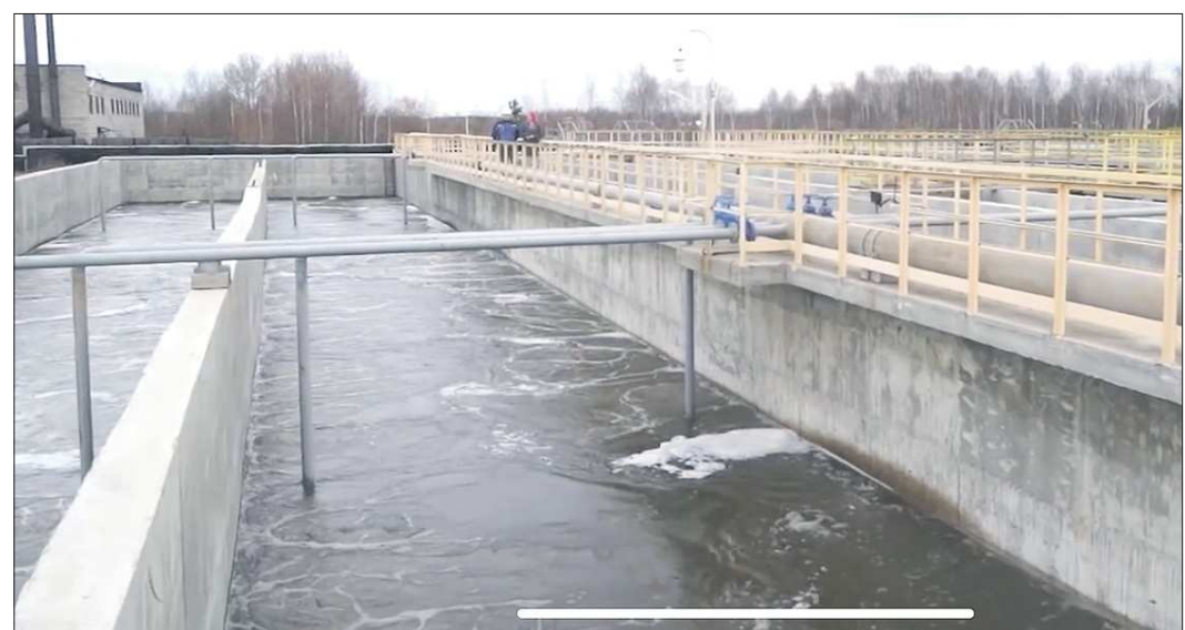
В Серове идут испытания очистных
