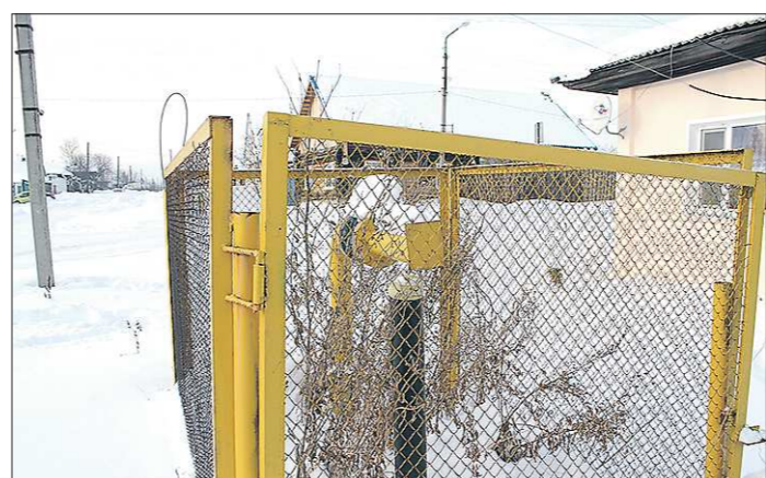
Краны подключения к магистральному газопроводу на перекрёстке Гоголя и Коллоногова уже четыре года находятся в неизменном состоянии. Власти обещают, что вопрос подключения домов к газу должен решиться в ближайшие годы
