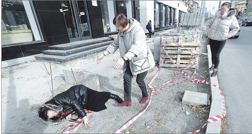
Предупредительная лента иногда становится не ограждением, а источником повышенной опасности
