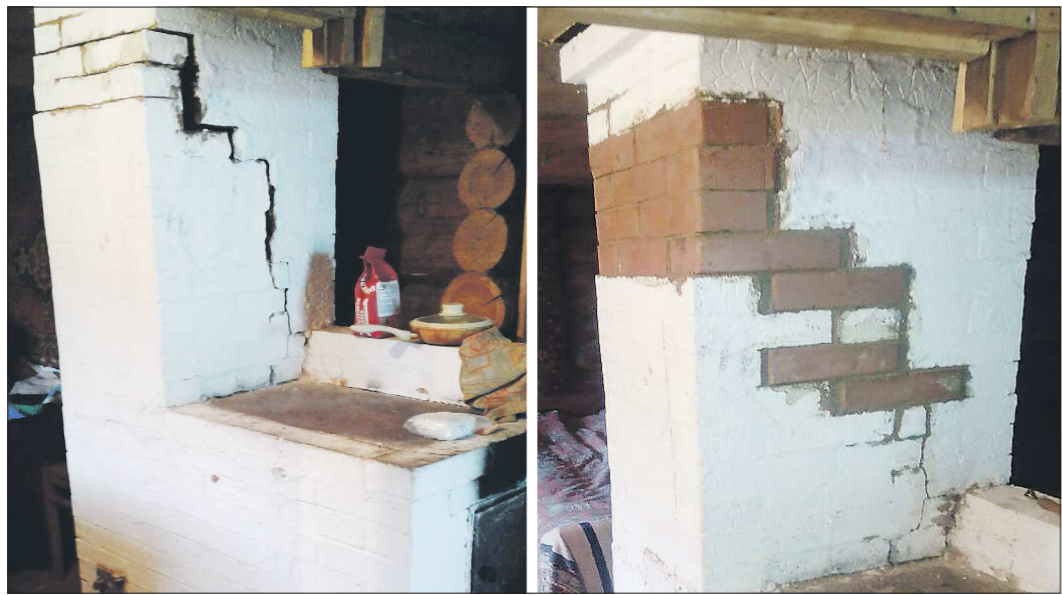
На первом фото видно, как выглядела печь Виталия Пырина до ремонта после смещения дымохода. А рядом уже отремонтированная профессионалами печь, простым замазыванием щели такого эффекта было бы не достичь
