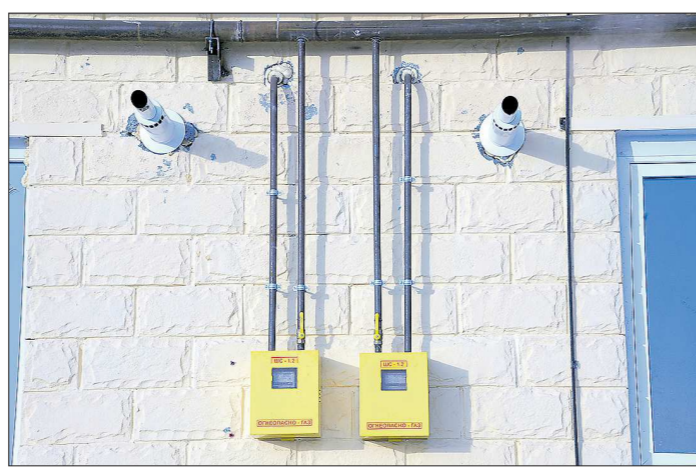
По правилам, всё должно быть так же, как на фото: счётчик газа на улице, трубы вывода продуктов сгорания смонтированы по требованиям
