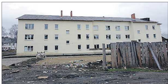
Вместо того чтобы обживать новые квартиры, кедровчане ждут, когда промёрзший дом восстановят после зимы и благоустроят
