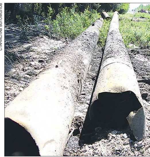
Почему уложили трубы неподходящего диаметра, теперь, наверное, и не узнать
