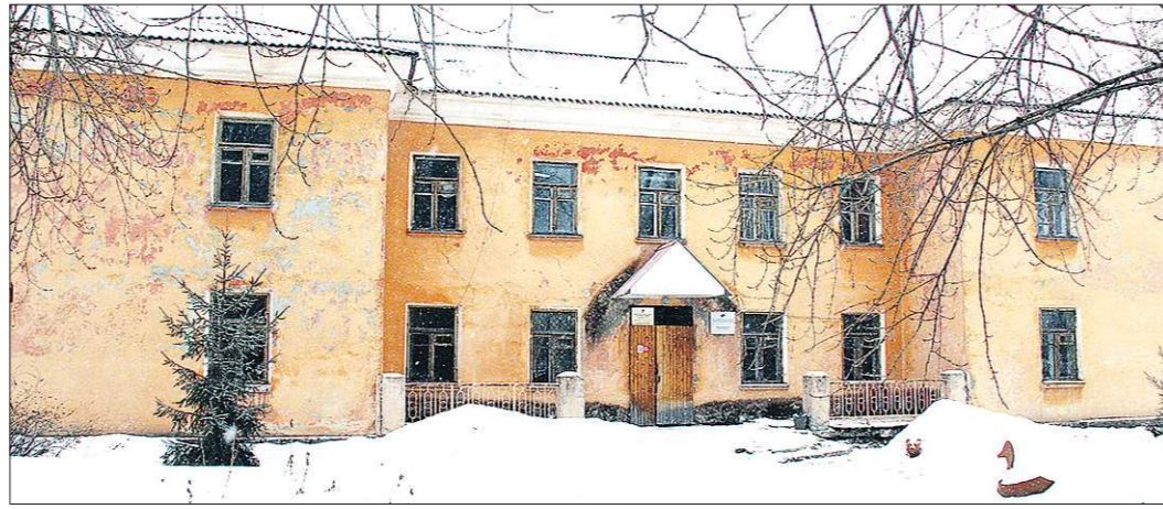
Несмотря на жалобы врачей, прежнему руководству районной больницы оказалось не под силу организовать отселение здания, зияющего трещинами в стенах и дырами в полу. Эту неотложную задачу теперь предстоит решать совместно с администрацией городского округа новому главврачу ЦРБ Игорю Брагину, заступившему на должность в начале этого года
