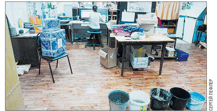
Во время осадков с потолка падает штукатурка, мигает свет и произвольно выключаются компьютеры, что не может не сказаться на работе почтovieков с посетителями
