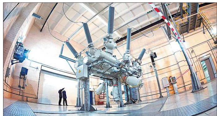
С пуском «Приречной» все новые объекты экономического и социального значения, а также жильё будут обеспечены надёжным электроснабжением
